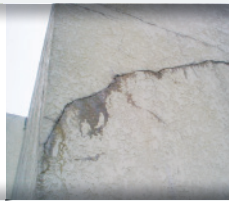
ผนังร้าว Cracked Wall
